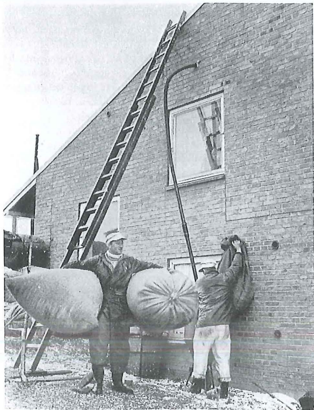
Blandt de mange materialer, der kan anvendes til isolering af hule mure, er styrol-skum i form af kugler (Flamingokugler). Materialet er fjerlet og yder ikke noget tryk på muren. Det er fuldstændig vand-skyende og skulle derfor bevare isoleringsevnen
